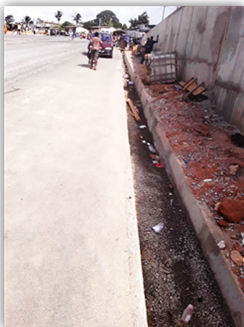
Photo 6 : Caniveau sous dimensionné Source : les auteurs
