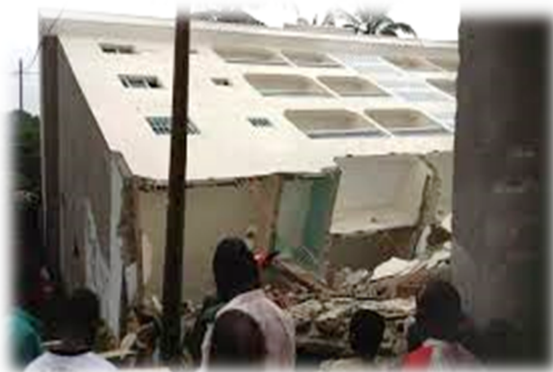
Photo 3 : Effondrement d'un immeuble ne répondant pas aux normes de construction à Abidjan
