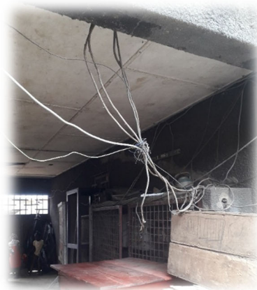
Photo 5 : Branchement anarchique à l'entrée d'une habitation Source: les auteurs
