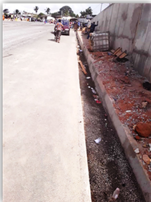
Photo 6 : Caniveau sous dimensionné Source : les auteurs
